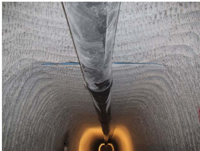
Foto 18: Speicherstrecke 2 auf Höhe der Altbohrung A675 auf der 800-m-Sohle, NW-Blick, Firste (Aufnahmedatum: 02.08.2013)
