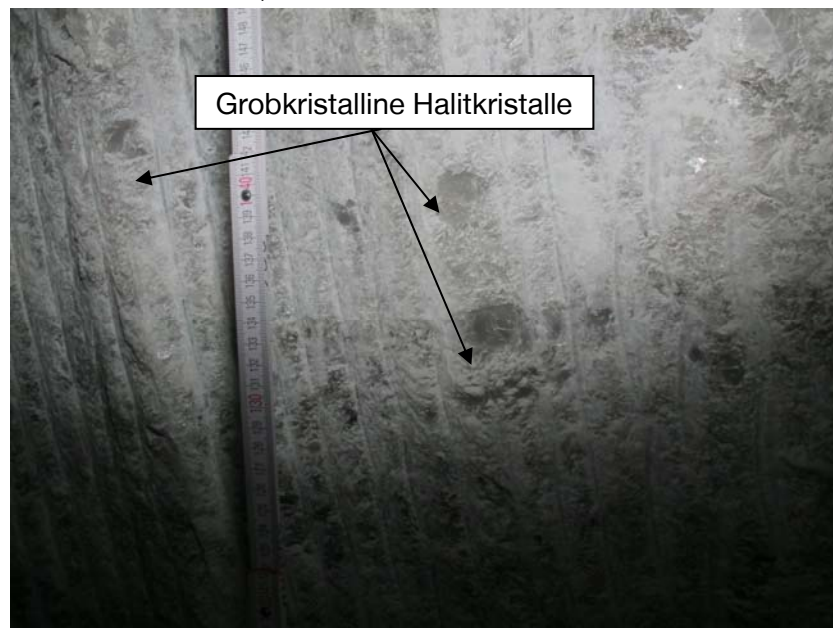
Foto 52: NE-Stoß der Speicherstrecke 4 nach geschätzten 25 m auf der 800-m-Sohle – Grobkristalline Halitkristalle (Detailansicht von Foto 50, Aufnahmedatum: 29.08.2013)
