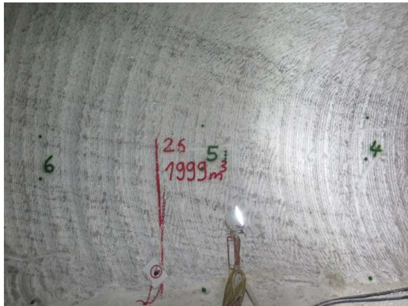
Foto 48: NE-Stoß der Speicherstrecke 4 nach geschätzten 10 m auf der 800-m-Sohle (Aufnahmedatum: 07.10.2015)
